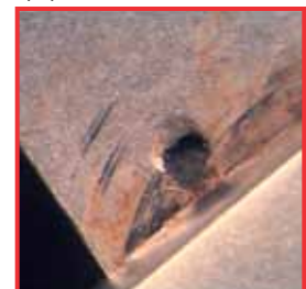
Exemple de corrosion par piqûres
