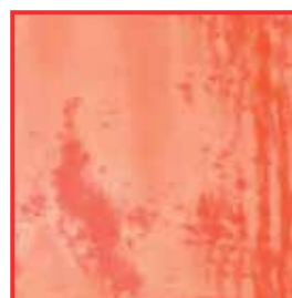
Attaque du matériau de la surface d'aluminium anodisé nature/coloré de conteneurs. Cause : solution de lavage trop fortement alcaline
