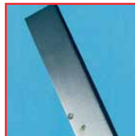
Exemple de corrosion par piqûres
